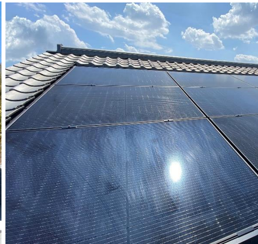
屋根一体通気型の太陽光発電システム
